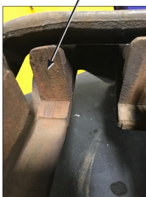
Rouille sur la surface d'appui
